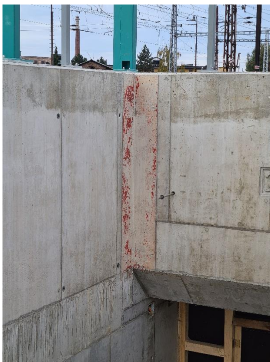
Obr. 41: Otisk barvy z rohového panelu bednění na povrch betonu a vyplavení řídkého cementového tmele do horní části konstrukce, zdroj: vlastní
