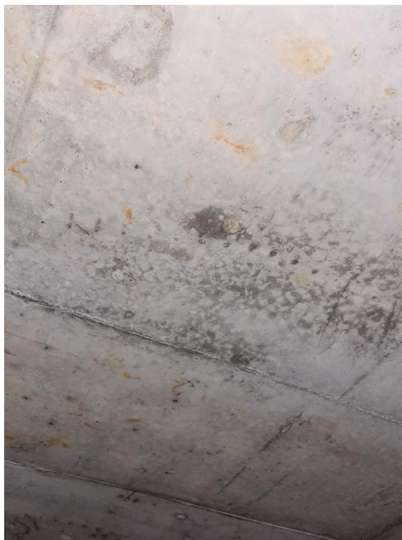
Obr. 49: Otisk poškozené bednicí desky na povrchu betonu a otisk rzi z nečištěného pláště bednění, zdroj: vlastní
