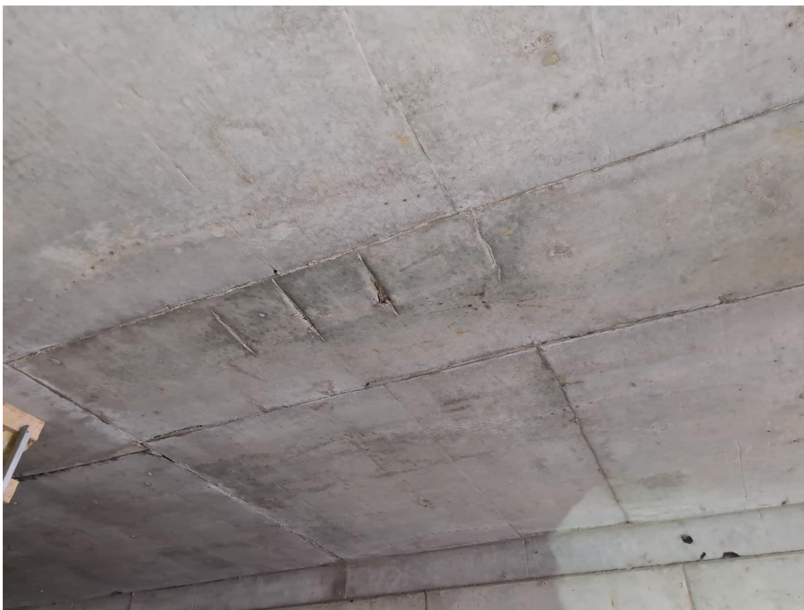
Obr. 52: Otisk poškozené bednicí desky na povrchu betonu, zdroj: vlastní
