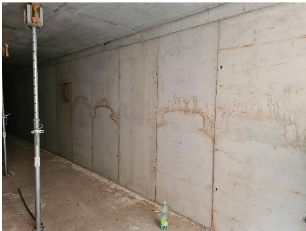
Obr. 46: Otisk skvrn rzi z nečištěného pláště bednění na povrch, zdroj: vlastní
