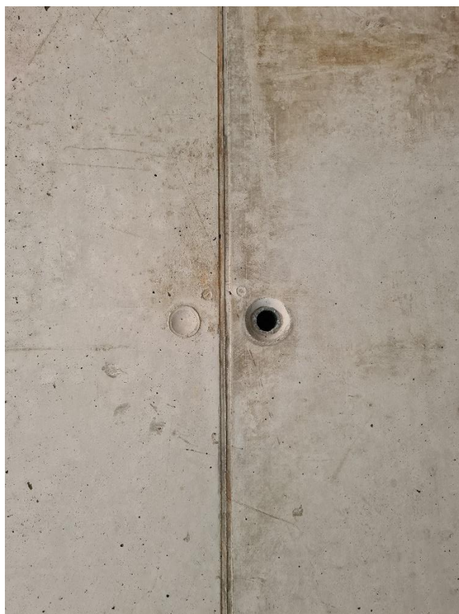
Obr. 45: Detail otvorů po spínání a otisk nečistot na povrch betonu, zdroj: vlastní
