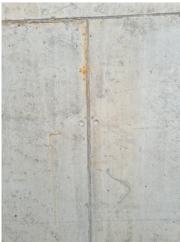
Obr. 51: Otisk skvrn rzi z neočištěného pláště bednění na povrch, zdroj: vlastní
