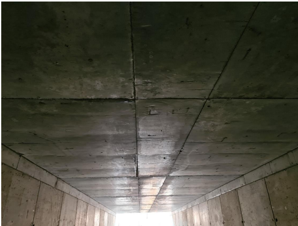
Obr. 44: Viditelně zvlňný povrch betonu stropu způsobený průhyby bednicích desek a viditelné obtisky poškození bednicích desek do povrchu betonu, zdroj: vlastní
