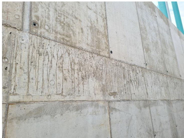
Obr. 40: Únik cementového tmele vlivem netěsného bednění u pracovní spáry, zdroj: vlastní
