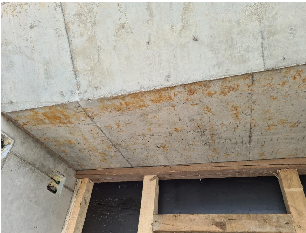
Obr. 43: Otisk skvrn rzi z neočištěného pláště bednění na povrch betonu stropu, zdroj: vlastní
