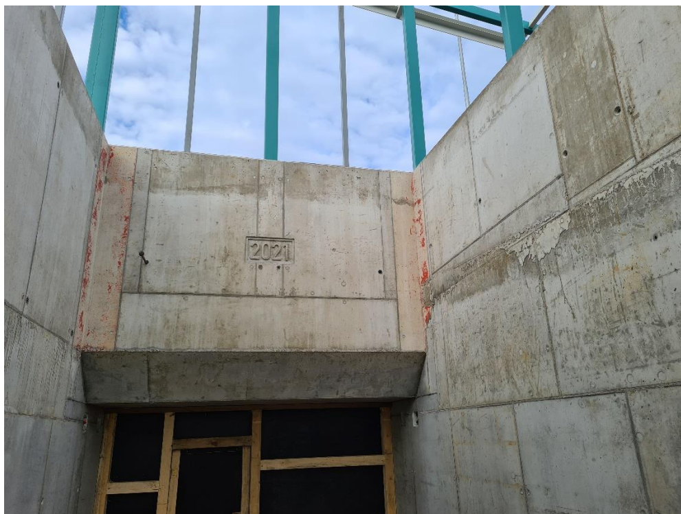
Obr. 47: Otisk barvy z rohového panelu bednění na povrch betonu, otisky rzi na povrchu betonu, odchylky barevných odstínů, vytečení cementového tmele v pracovní spáře a vyplavení řídkého cementového tmele do horní části konstrukce, zdroj: vlastní
