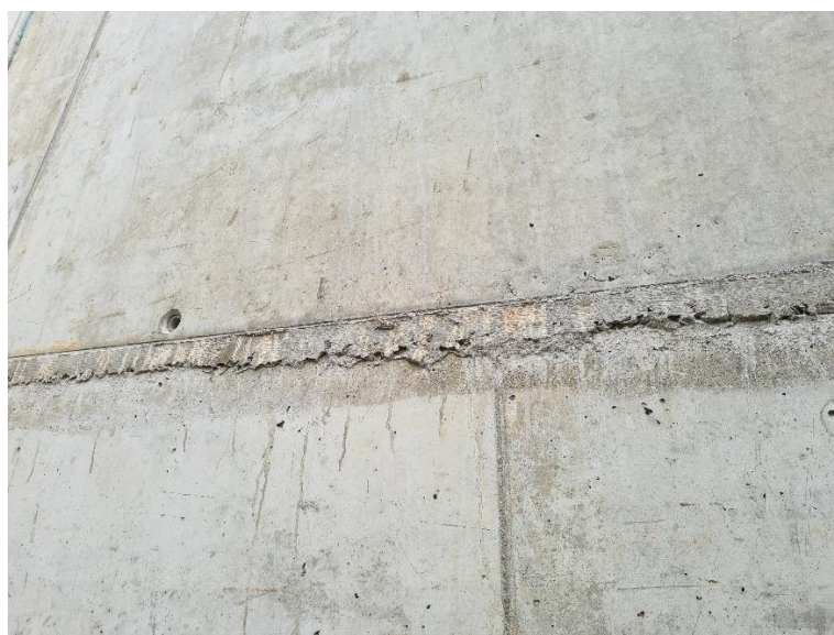
Obr. 42: Netěsné navázání na předchozí záběr, zdroj: vlastní
