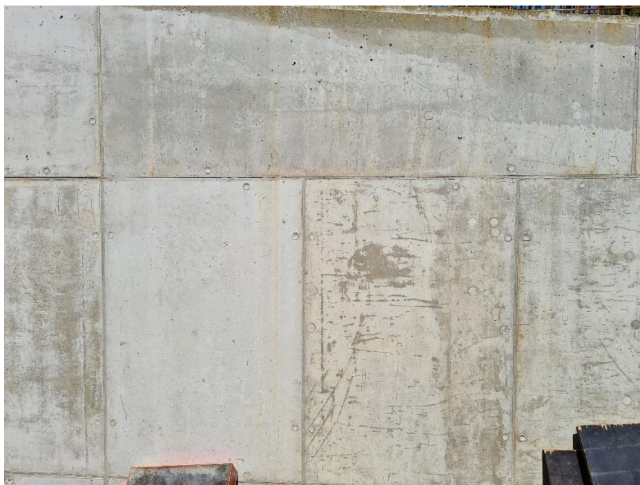
Obr. 48: Skvrny na povrchu způsobené nanesením velkého množství špatně rozetřeného separačního postříku, zdroj: vlastní
