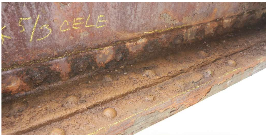
Obr. 26: Oslabení vnitřních krčních úhelníků dolního pasu
