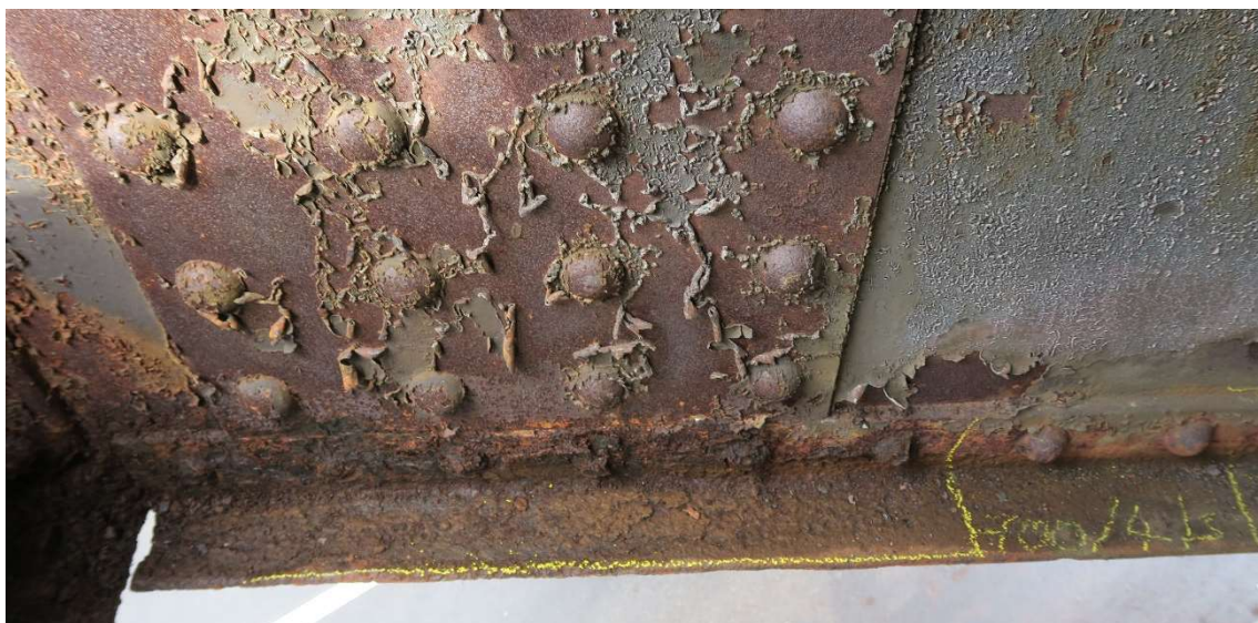
Obr. 38: Oslabení krčních úhelníků (dolní pásnice) příčnicku
