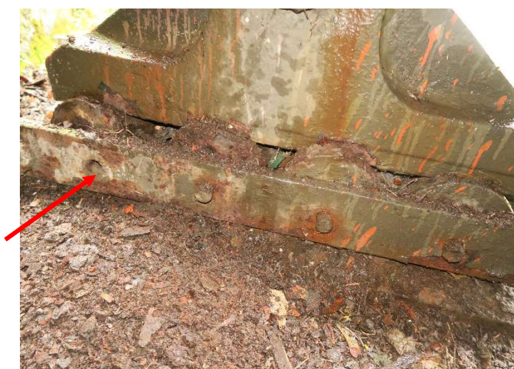
Obr. 53: Koroze a chybějící fixační šroub válečkového ložiska (pravé, OP2)
