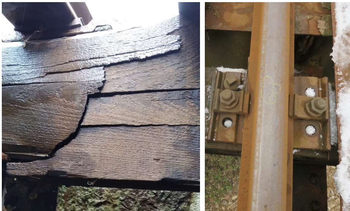
Obr. 55: Prasklá mostnice s příčnou trhlinou a chybějící vrtule
