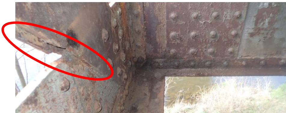
Obr. 28: Korozní oslabení styku diagonály a dolního pasu
