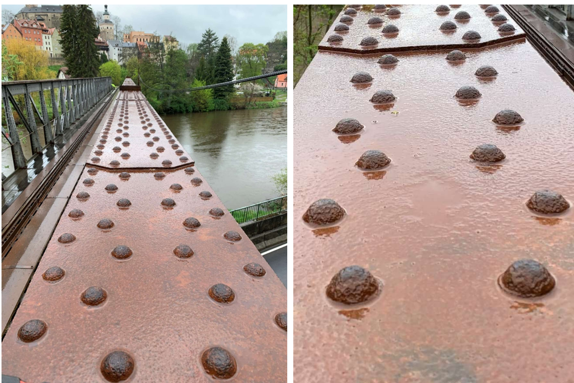
Obr. 23: Celkový pohled na horní pas a detail důlkové koroze plechu a nýtů
