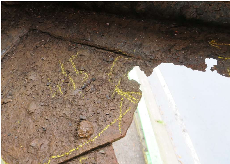
Obr. 25: Korozní oslabení dolního pasu a styčnickového plechu ztužení
