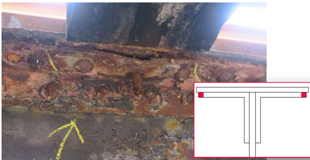
Obr. 43: Detail koroze podélníku pod mostnicí (levý podélník)
