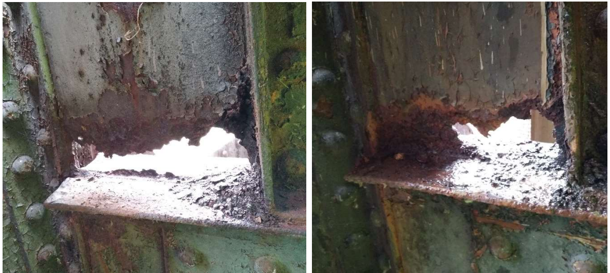
Obr. 35: Koroze příčných výztuh v místě napojení na příčník
