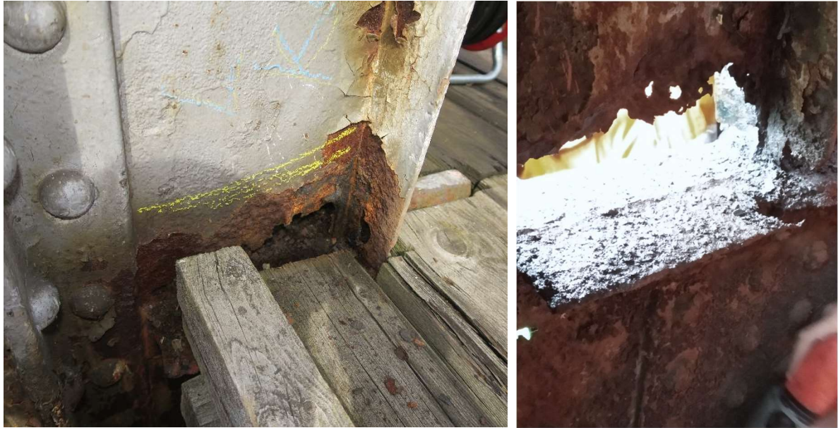
Obr. 34: Koroze výztuh svislic (vlevo u chodníkových podlah, vpravo u příčníku)
