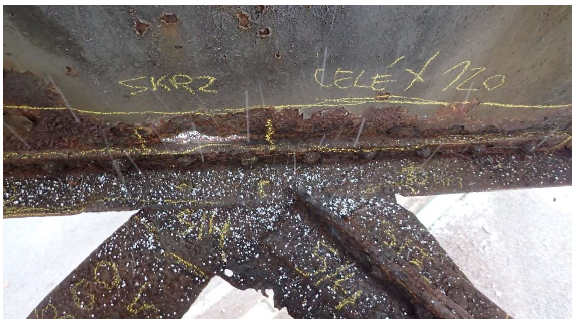
Obr. 39: Oslabení dolní pásnice příčnicku a přípoje ztužení
