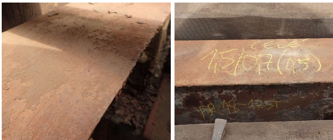
Obr. 41: Povrchová koroze horní pásnice příčnicku
