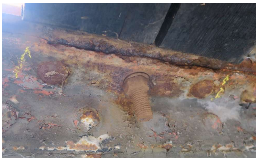
Obr. 44: Detail koroze podélníku pod mostnicí (pravý podélník)
