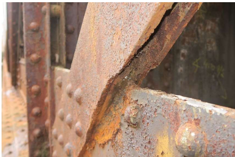
Obr. 30: Lokální oslabení diagonály u dolního pasu
