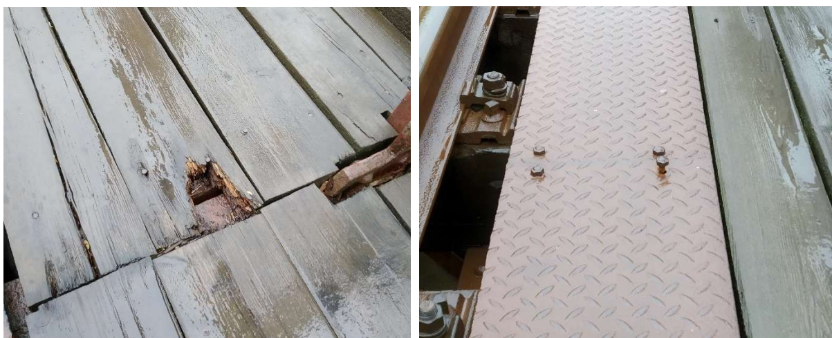
Obr. 56: Hniloba dřevěných podlah a uvolněné šrouby krycích plechů
