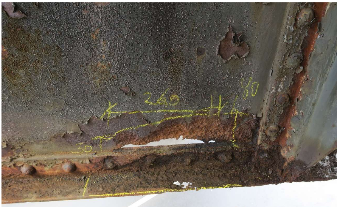
Obr. 37: Oslabení krčních úhelníků (dolní pásnice) a stěny příčniku
