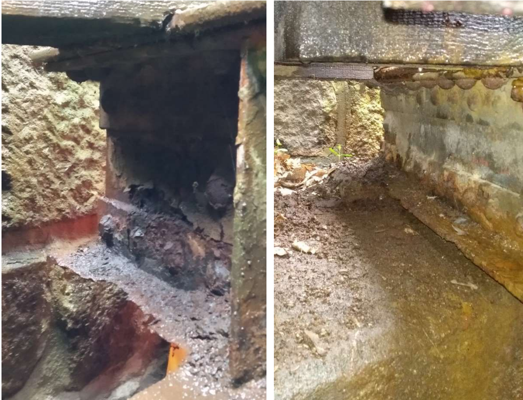
Obr. 45: Koroze koncových podélníků u opěr
