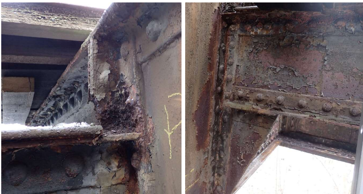
Obr. 40: Koroze v místě připojení podélníku k příčnicku
