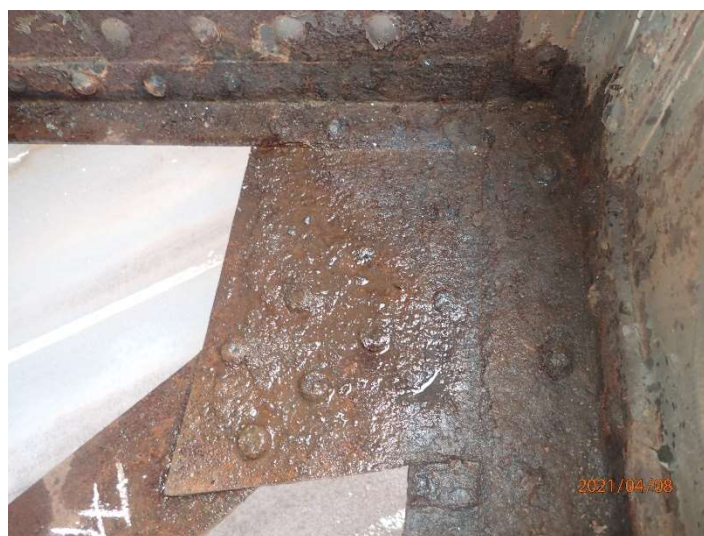
Obr. 48: Koroze přírub T-průřezu ztužení, oslabení st. plechu a nýtů
