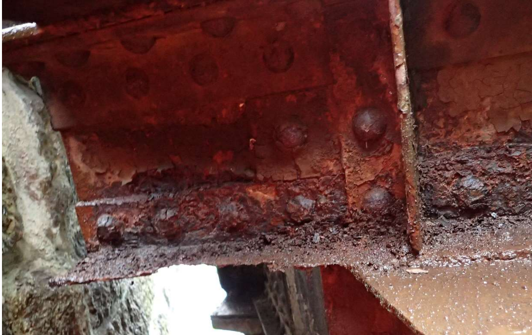
Obr. 46: Koroze koncového podélníku u opěry OP1
