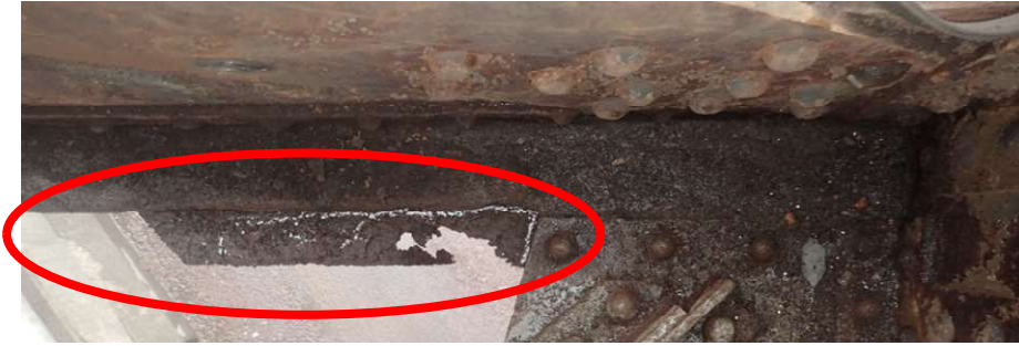
Obr. 24: Oslabení a otvory pásnice dolního pasu
