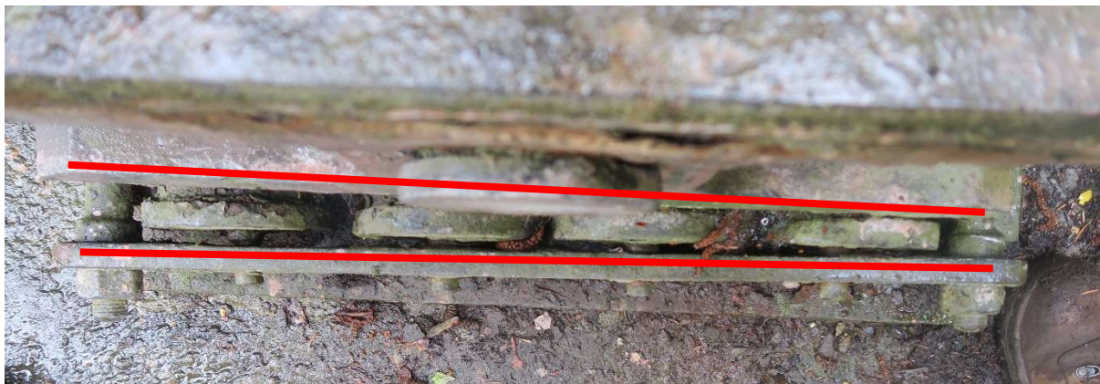
Obr. 54: Zkosení pravého ložiska na OP2
