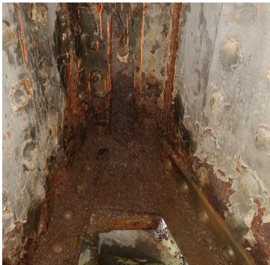
Obr. 42: Korozní oslabení v koncové oblasti u opěry OP1
