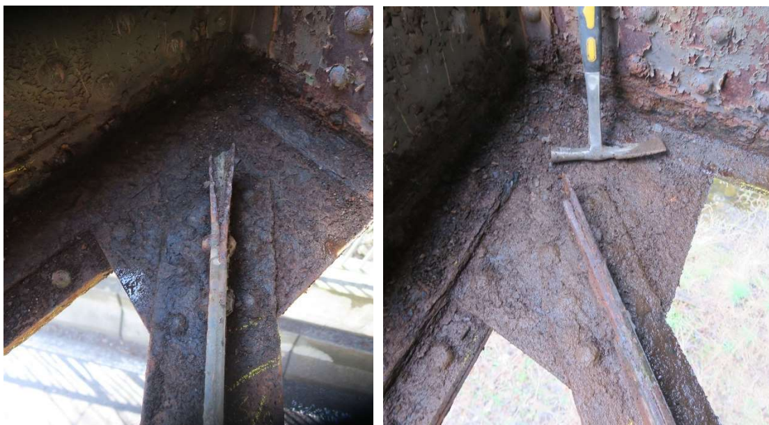
Obr. 47: Štěrbínová koroze a oslabení ztužení, styčnickového plechu a nýtů
