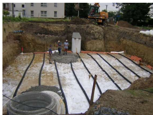
Obrázek 21 Podzemní vsakovací zařízení – v jámě je natahán drenážní systém, následně se výkop zasype štěrkem [24]
