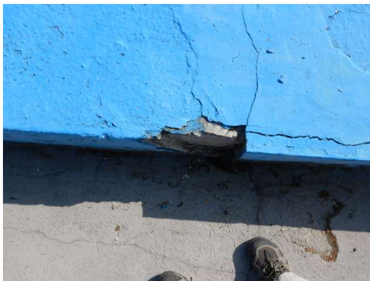
Obrázek 22 Detail poškozené bazénové vany [31]
