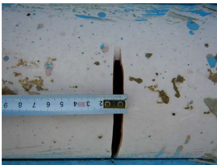
Obrázek 20 Detail vyfrézovaného otvoru do přívodního potrubí [31]
