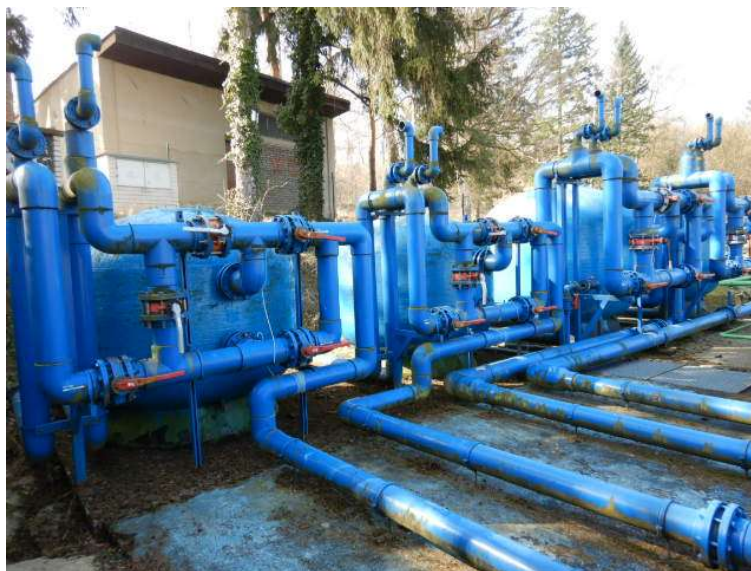
Obrázek 19 Filtry bazénové vody před rekonstrukcí [31]
