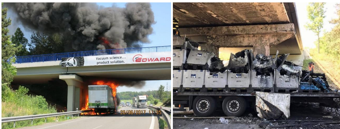
obr. 1: Požár kamionu a poškození mostní konstrukce na území ČR [6]
