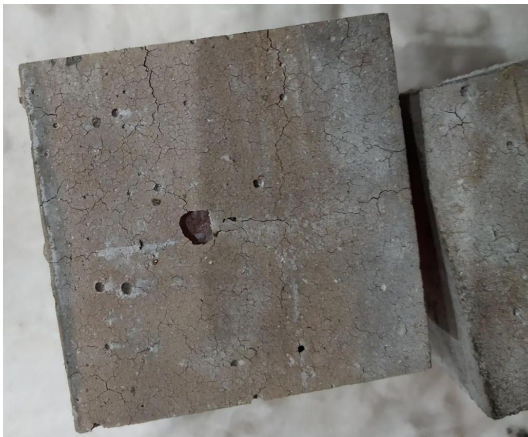
Obr. 34: Porušení povrchu vzorku ze skupiny 2 vysokými teplotami
