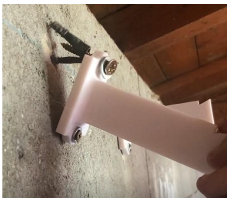
Obrázek 58 Vytržení součásti ze zdi v důsledku její vysoké nosnosti
