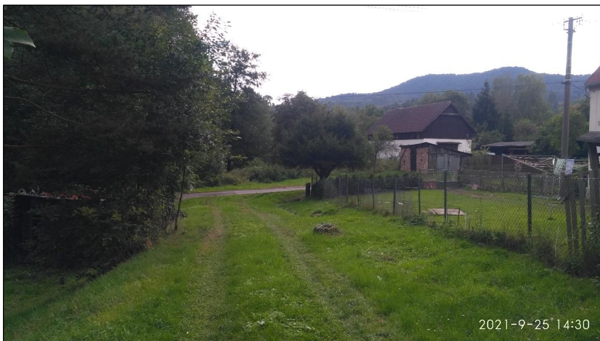
Obr. 69 Stávající stav tělesa trati přibližně v km 2,300 000, foto: autor
