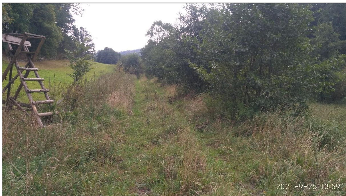
Obr. 59 Stávající stav tělesa trati přibližně v km 1,350 000, foto: autor
