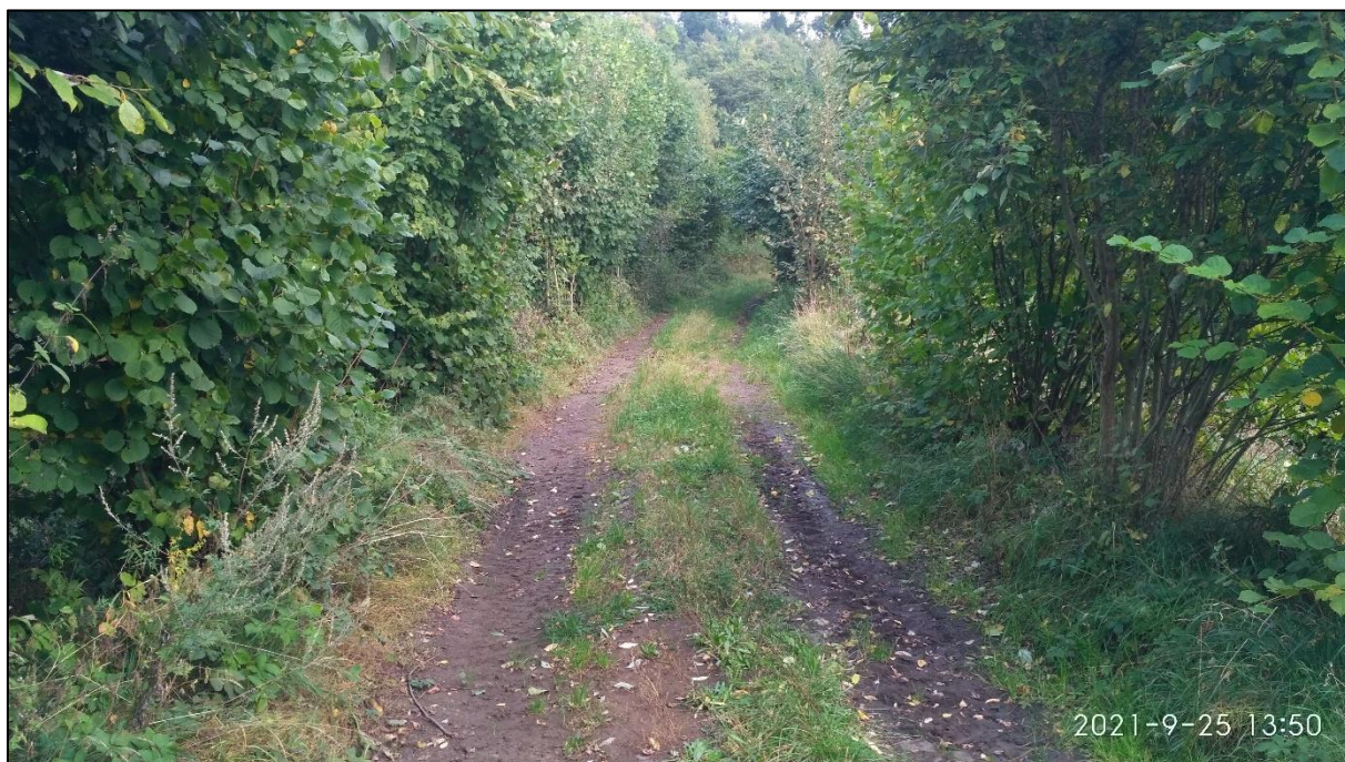
Obr. 54 Stávající stav tělesa trati přibližně v km 0,800 000, foto: autor
