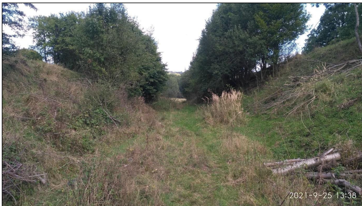
Obr. 41 Stávající stav tělesa trati přibližně v km 0,250 000, foto: autor
