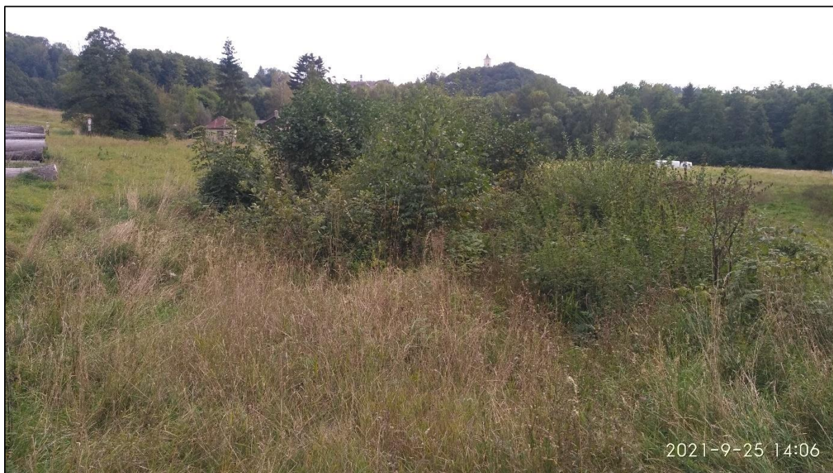
Obr. 62 Stávající stav tělesa trati přibližně v km 1,650 000, foto: autor
