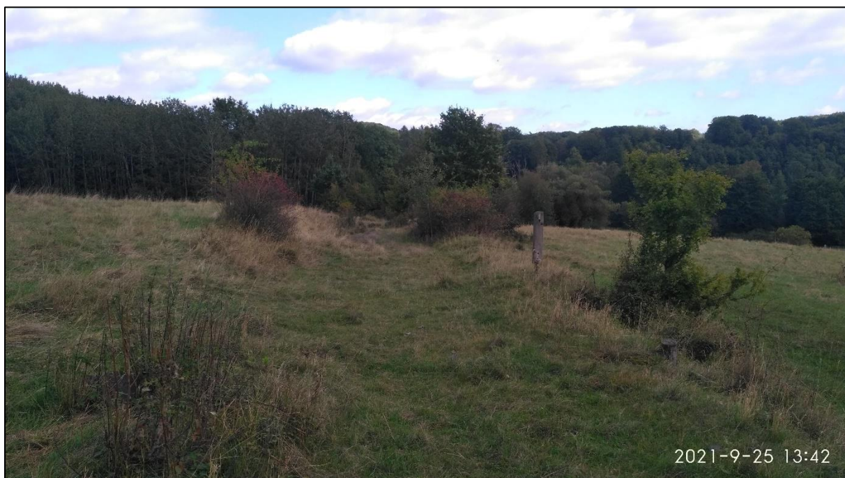
Obr. 45 Stávající stav tělesa trati přibližně v km 0,450 000, foto autor
