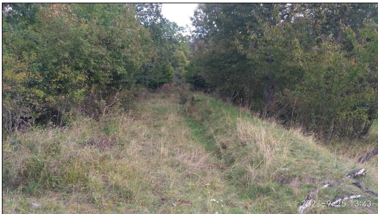
Obr. 46 Stávající stav tělesa trati přibližně v km 0,550 000, foto: autor
