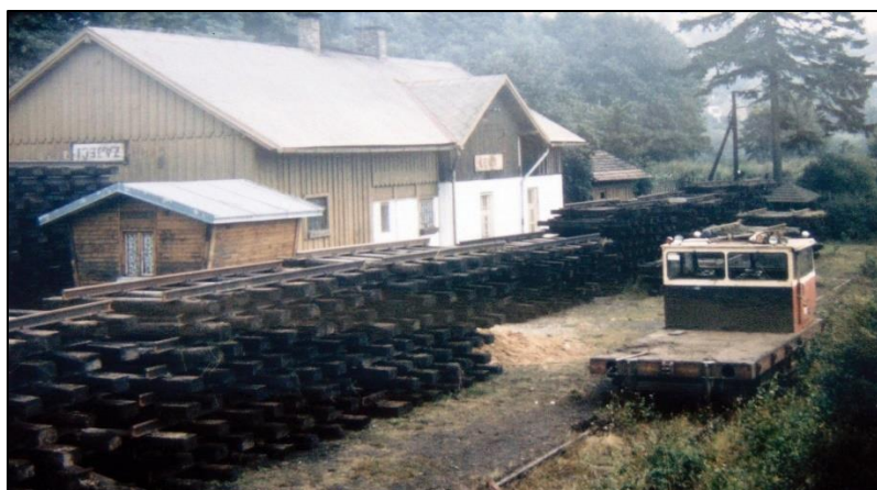
Obr. 24 Snesená kolejová pole ve stanici Levín při částečné likvidaci trati Lovečkovice – Levín, foto: www.idnes.cz/zanikletrate [9]
