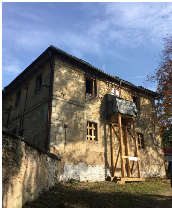
(21) Stav 2021 - objekt B severní křídlo, průčelí s balkónem vlastní fotografie
