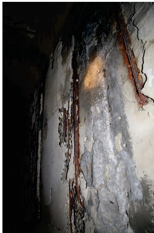
Obrázek 25 Nosníku I67 koroze výztuže [23]
