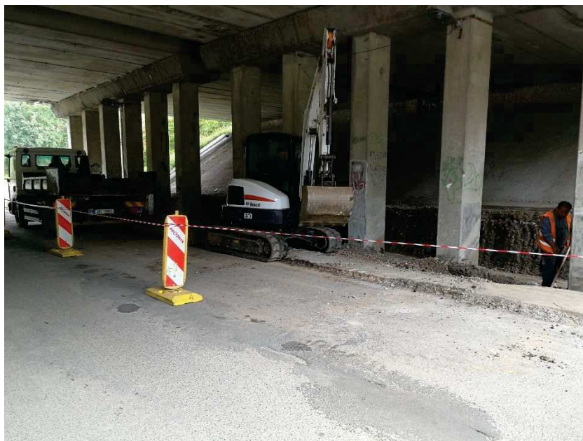
Obrázek 32 Pohled na stativa mostu D5-016 před podepřením [16]
