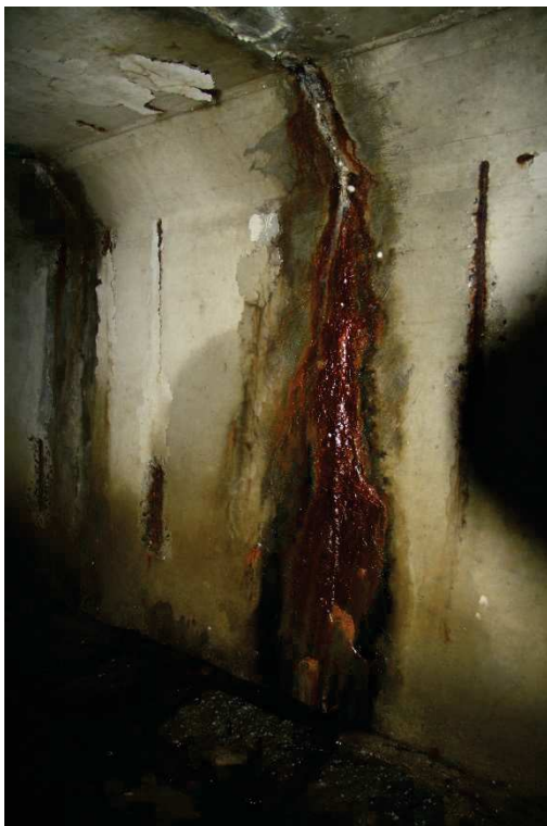
Obrázek 24 Nosník I67 zatékání [23]
