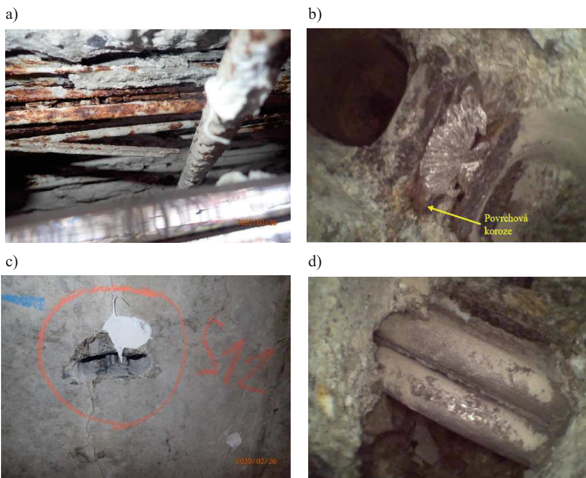
Obrázek 48 a) sonda zkorodované předpínací výztuže, b) sonda předpínací výztuže s odhalením povrchové koroze a nedokonale zainjektovaného kanálku, c) sonda S12 předpínací výztuže bez koroze d) detail sondy S12 a injektáže kanálku [18]
