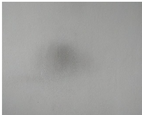
Obrázek 18: Znečištění stěny b)
