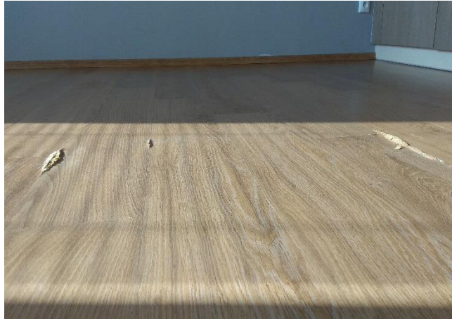
Obrázek 14: Poškození plovoucí podlahy v investičním bytě
