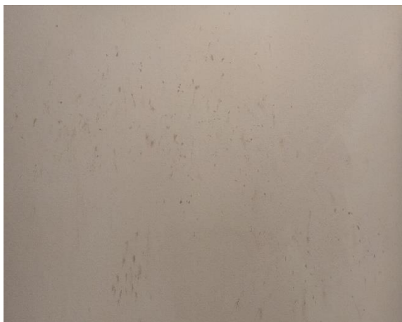
Obrázek 17: Znečištění stěny a)
