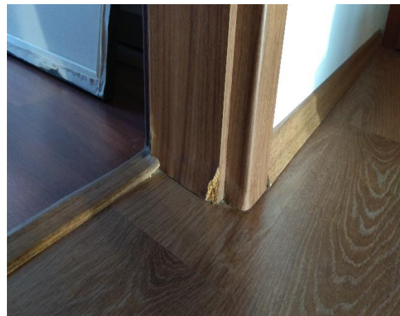
Obrázek 16: Poškození zárubně b)
