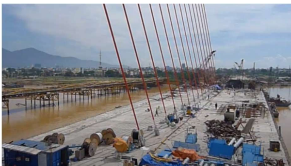
Obrázek 15. Blok s kabely (8)
