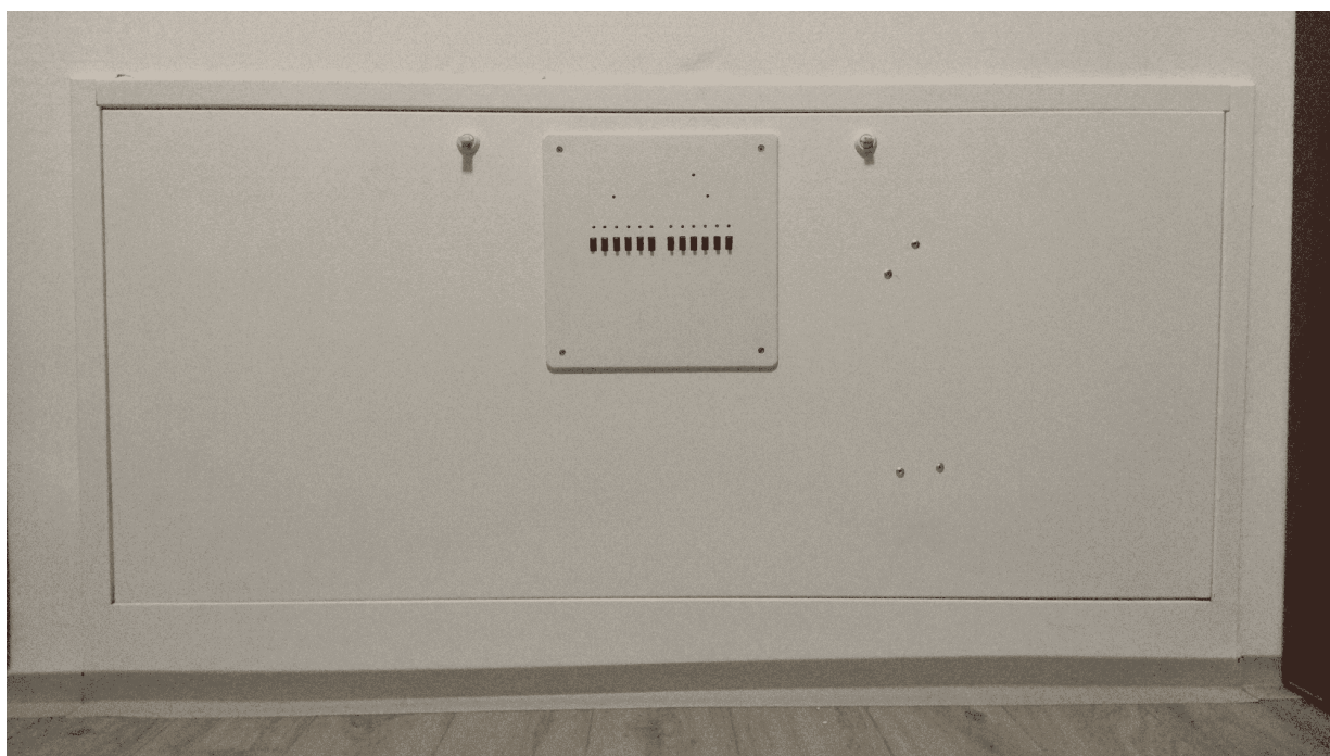
Obrázek E.1: Rozdělovač podlahové vytápění v přízemí – čelní strana.
