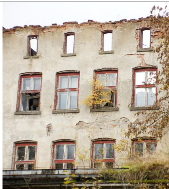
Obr. 44 Severovýchodní fasáda s dochovanou horní řadou oken půdního prostoru ve stavu z roku 2016 továrny Josef Riedel v Dolním Maxově, zdroj: archiv autora
