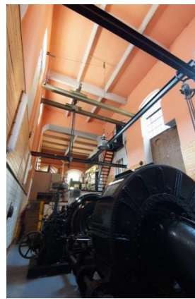
Obr. 167 Vodní elektrárna, zdroj: archiv autora
