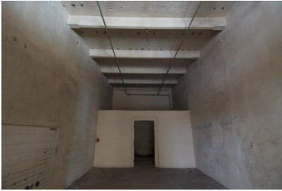
Obr. 163 Místnost v technické části, přístupná z podesty 4. NP, zdroj: archiv autora
