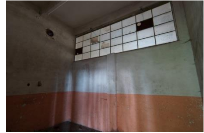
Obr. 165 Místnost v technické části, pohled na stejnou stěnu jako na předchozí fotografii z druhé strany, zdroj: archiv autora
