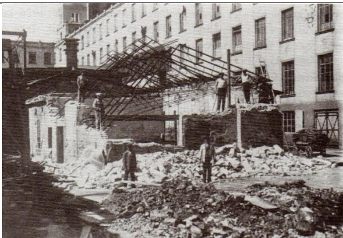
Obr. 101 Snímek z roku 1926 zachycuje původní členění okenních výplní a zdobné prvky fasády, zdroj: Jaroslav Rýdl – Paměť Tanvaldska
