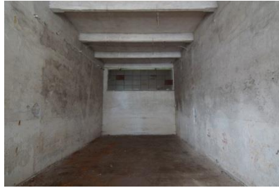
Obr. 164 Místnost v technické části, přístupná z podesty 3. NP, zdroj: archiv autora
