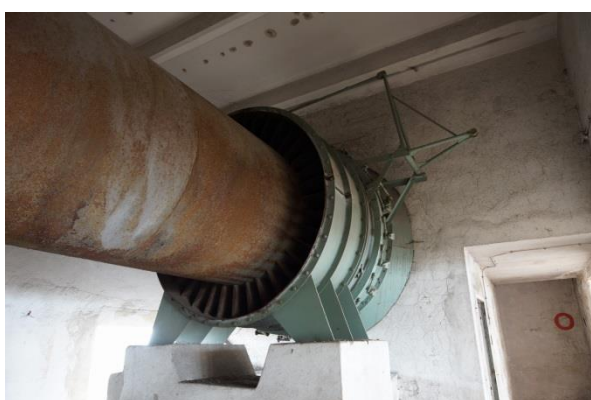
Obr. 130 Technologie klimatizace 4. NP, zdroj: archiv autora
