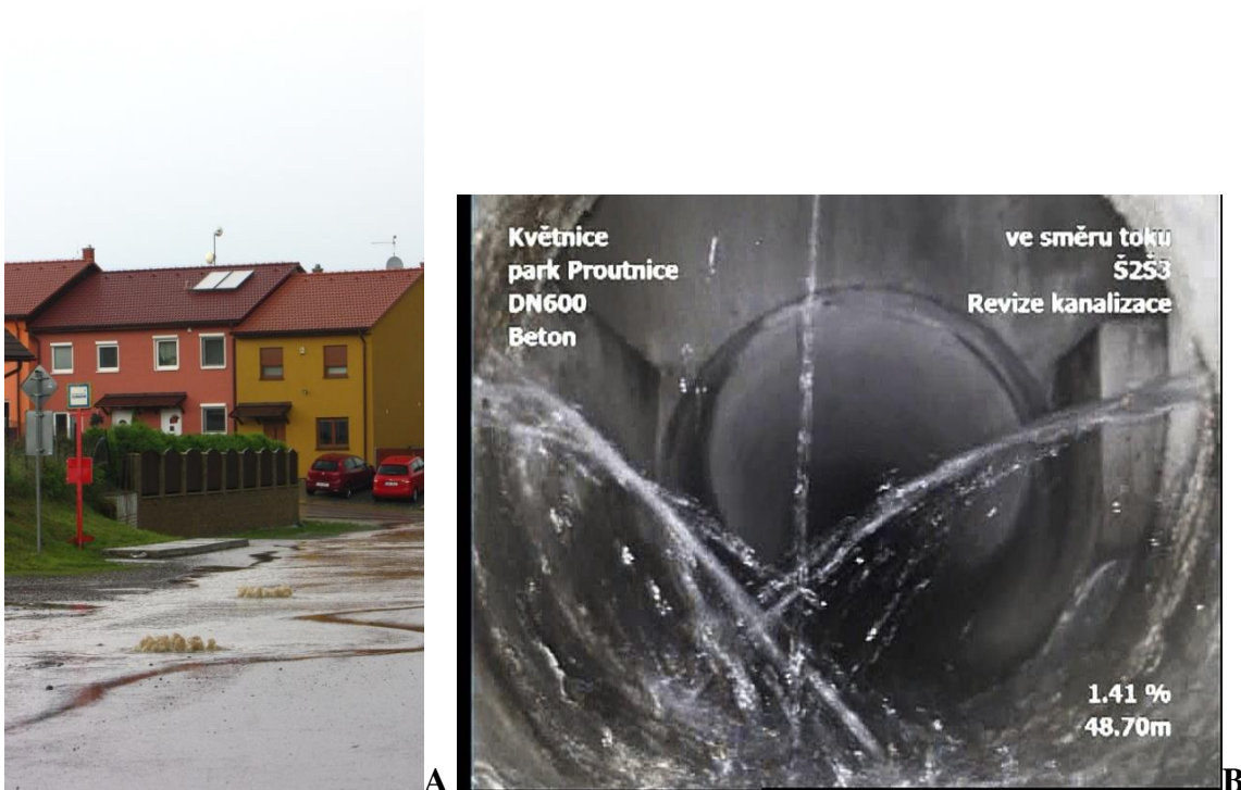
Obr. 2. A-Problém živelného přetěžování jednotné kanalizační sítě potenciálně vyvolávající hygienické znehodnocování veřejného prostoru sídel. B-Problém tolerance netěsností, paradoxně i v případě nově vybudovaných kanalizačních sítí.
