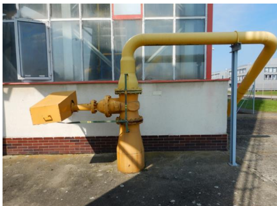
Obr. 21. Uzávěr plynové přípojky před kotelnou.
