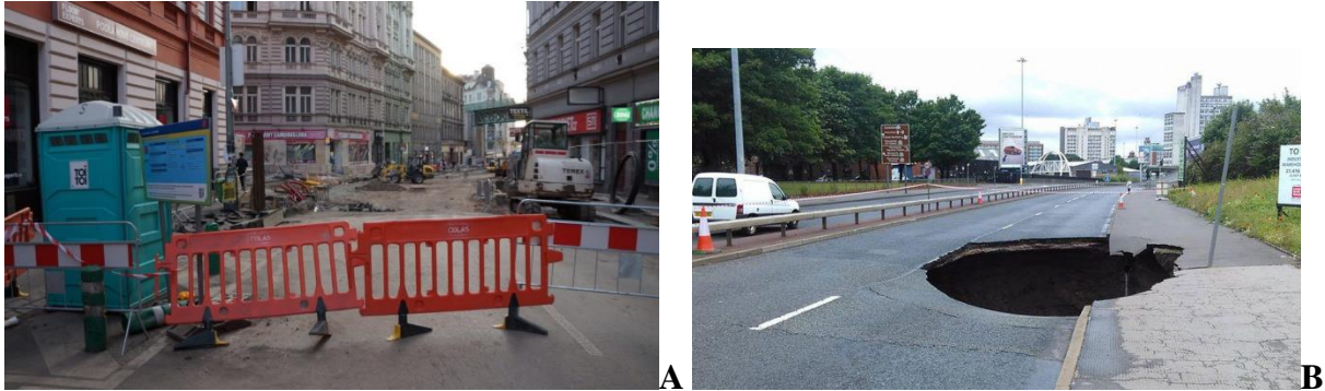
Obr. 1. A – Problém neodůvodněného častého upřednostňování výkopových technologií při obnově a kompletaci VTV/vedení technického vybavení znamená popření veřejného zájmu. B – Problém kavernózních jevů ve veřejném prostoru obvykle způsobených netěsným vodovodem a netěsnou kanalizací v jeho blízkosti.
