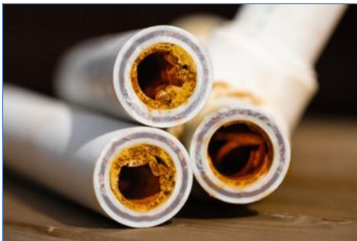
Obr. 1. Vodný kameň usadený na vnútornej strane potrubia [11].
