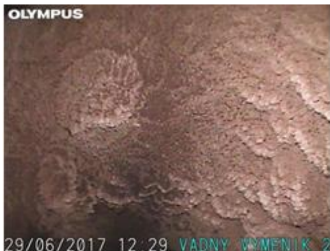
Obr. 5. Endoskopický snímek nejvíce zanešeného místa vstupu primární strany výměníku [15].
