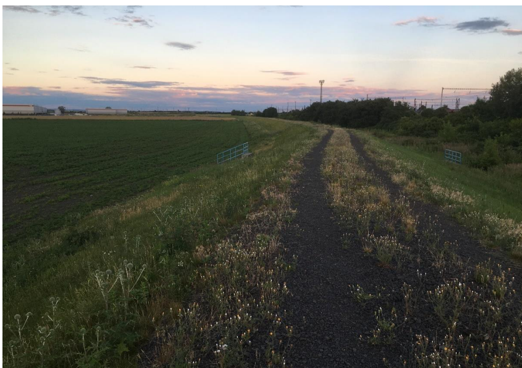
Obr. 25 - Protipovodňový val s povodňovou výpustí (vlastní fotografie)
