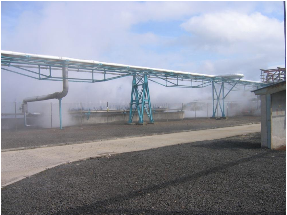
Příloha 2 Spuštěná parní clona (foto autor práce)
