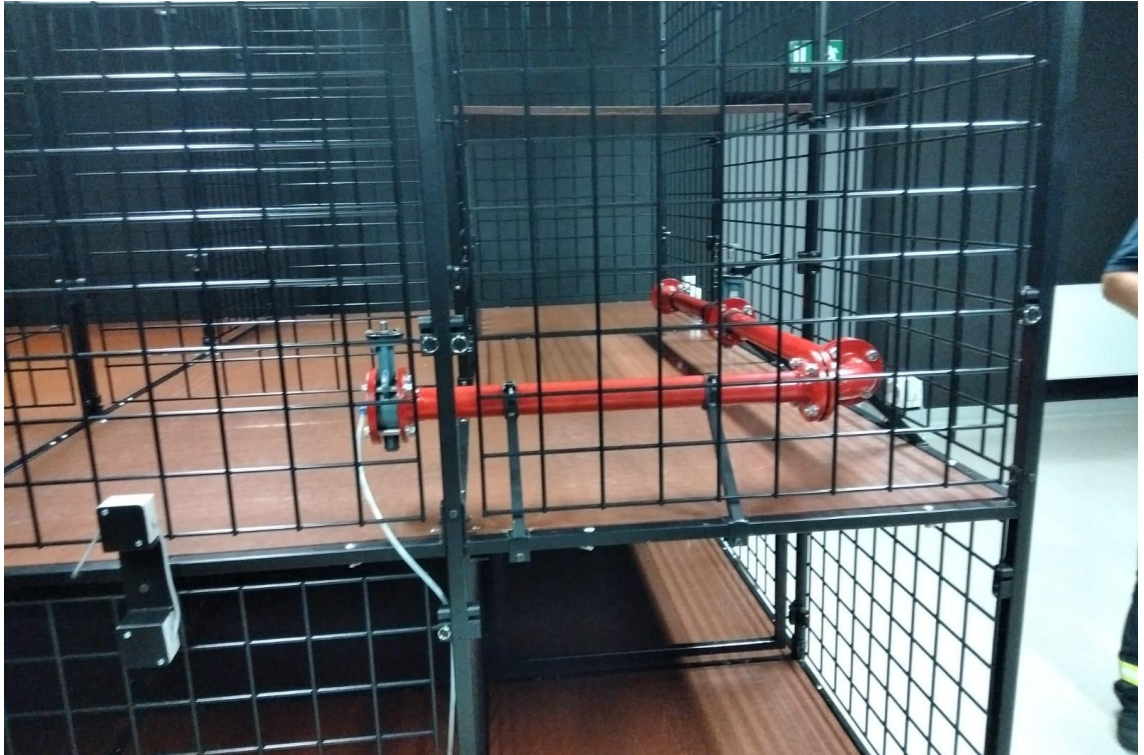
Obrázek 19 – Rozvod potrubí s NL v kleci [Zdroj autor]
