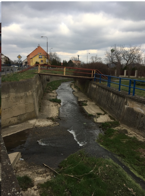
Hačka v betonovém korytu
