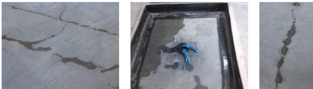
Obr. 1: Průsak konstrukcí bílé vany – OC Quadrio, Praha (foto autorka)
