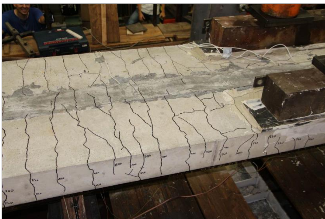
Obr. 144 Rozložení příčných trhlin před kolapsem nosníku s UHPC spojem
