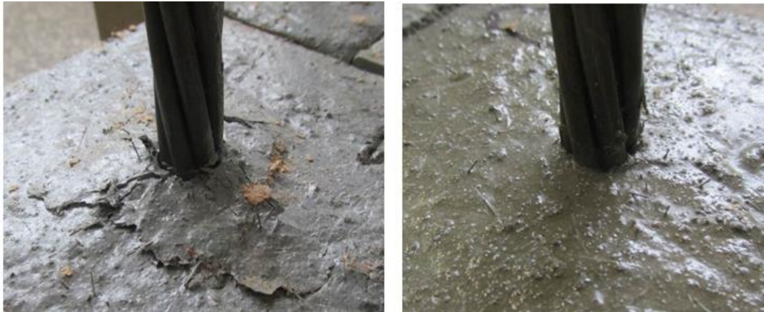
Obr. 100 Detail porušení vzorku z UHPC bez protikorozní ochrany (vlevo), s protikorozní ochranou typu U (vpravo)
