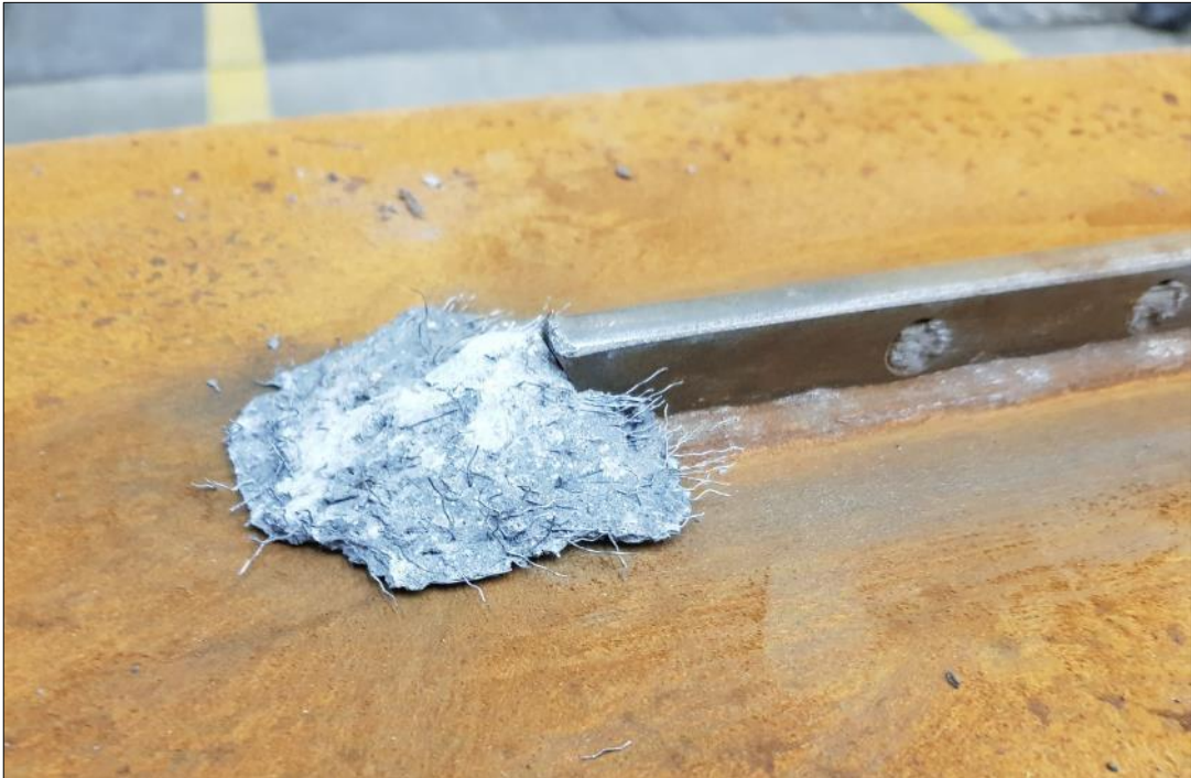
Obr. 125 Detail vytržení kuželu UHPC
