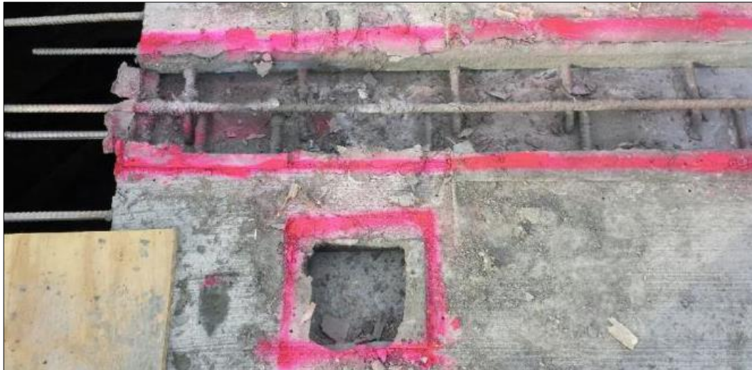
Obr. 65 Detail spoje a spřahovací kapsy při netěsnosti bednění [110]
