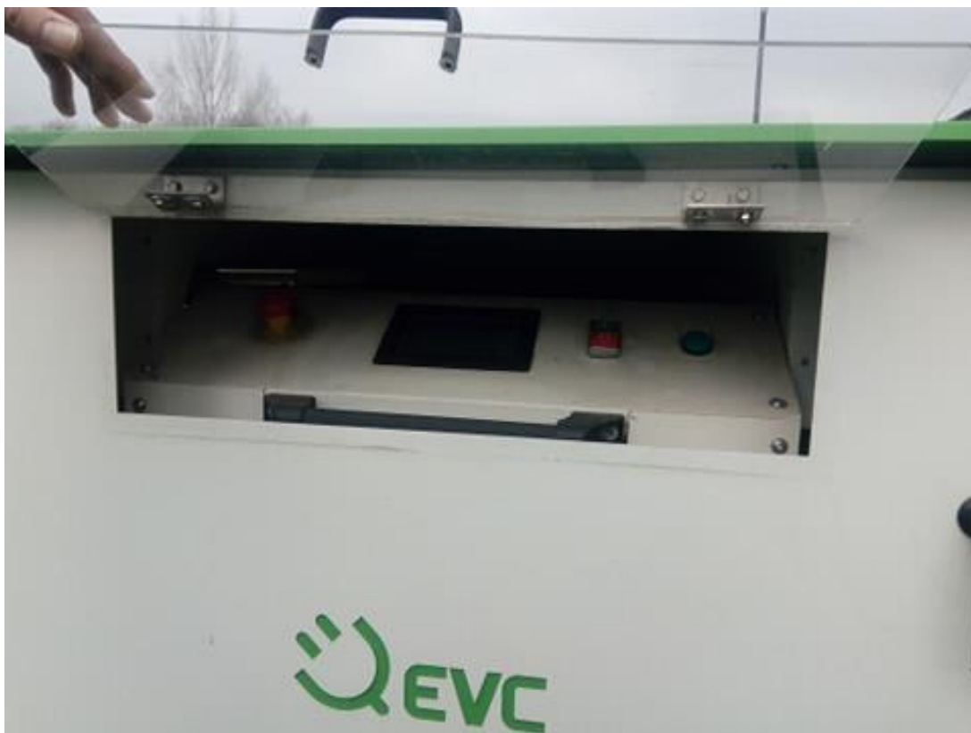
Obrázek 18.: Ovládací panel nabíjecí stanice [autor]
