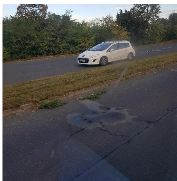
Obrázek 7: Stav silnice 2 II/608
