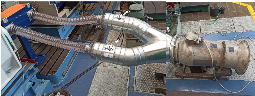
Obrázek 48: Ventilátor a rozvod vzduchu
