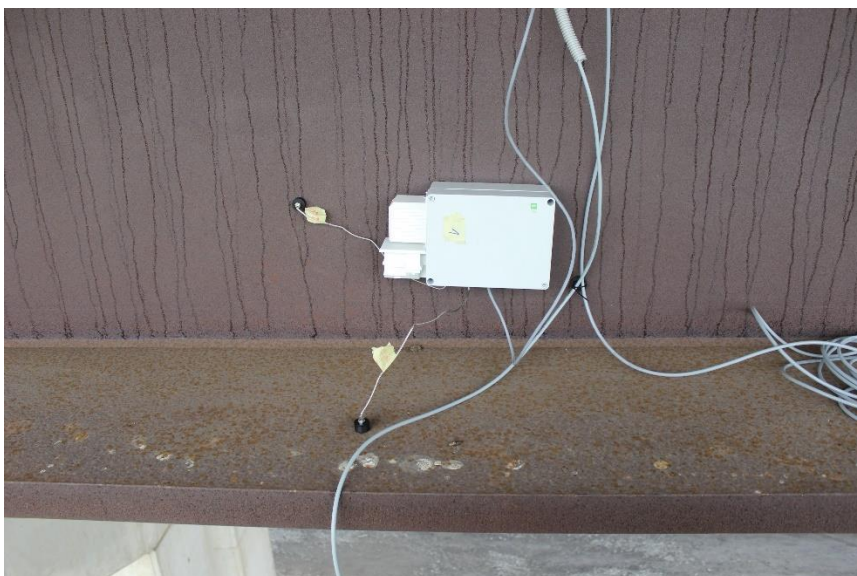
Obrázek 36: Monitorovací zařízení DCERA1
