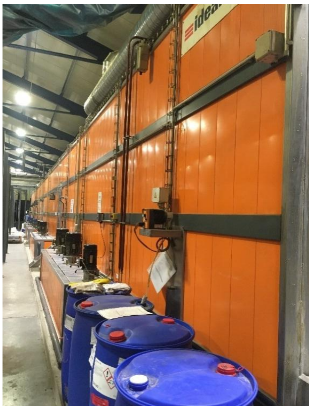
Obrázek 7: Automatická linka IDEAL LINE na předúpravu povrchu
