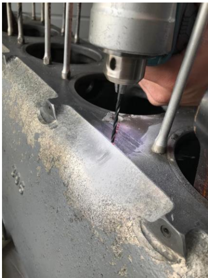
Obrázek 73: Stop-drilling koncové části praskliny [48]
