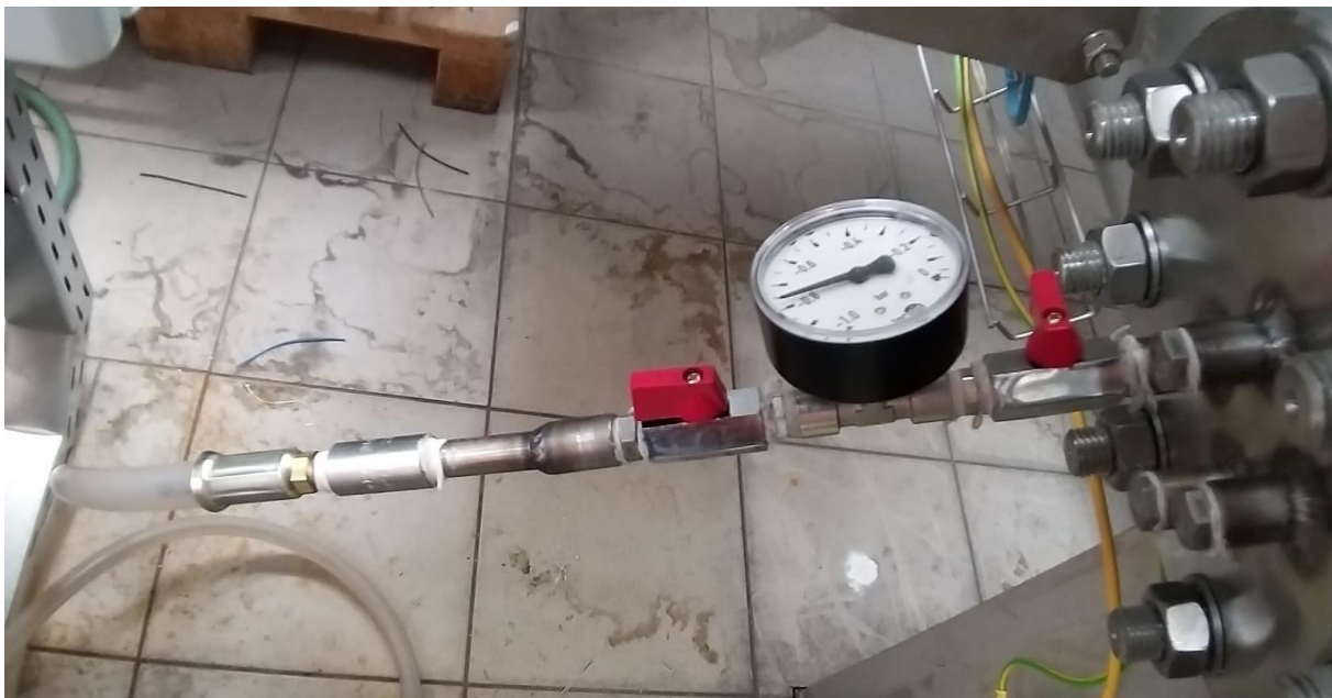
Obrázek 64: Ventily pro uzavření odsávání a kontrolní barometr
