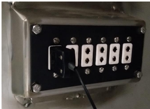
Obrázek 38: Konektory pro připojení termočlánků (ve vnitřním prostoru autoklávu)
