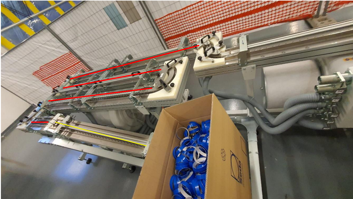
Obr. 31: Jet elevátor (žlutě) a následný prostor pro technologickou zásobu papírových kroužků (červeně) [Autor]
