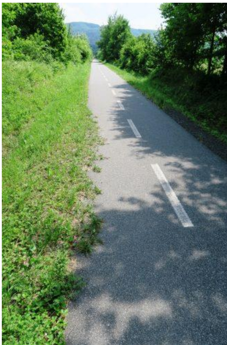
Obrázek 9 - Tráva prorůstající skrze vrstvu asfaltu na drážní stezce Nový Jičín - Hostašovice, [28]
