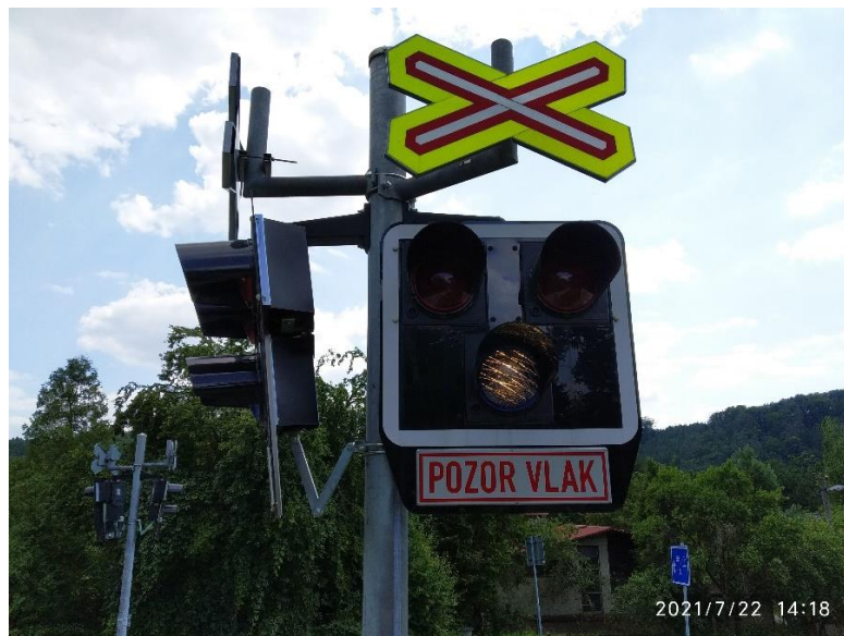
Obrázek 32 - Světelné přejezdové zařízení typu AŽD 97
