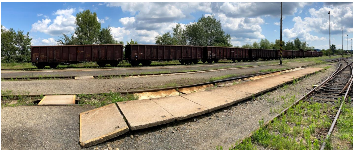
Obrázek 12 - Jeden ze zpevněných úseků nástupiště (dl. 16 m) u koleje č. 3, druhý úsek (dl. 30 m) je k vidění na obr. č. 11 (zdroj: [Adam Hoffmann, 10. 7. 2021])
