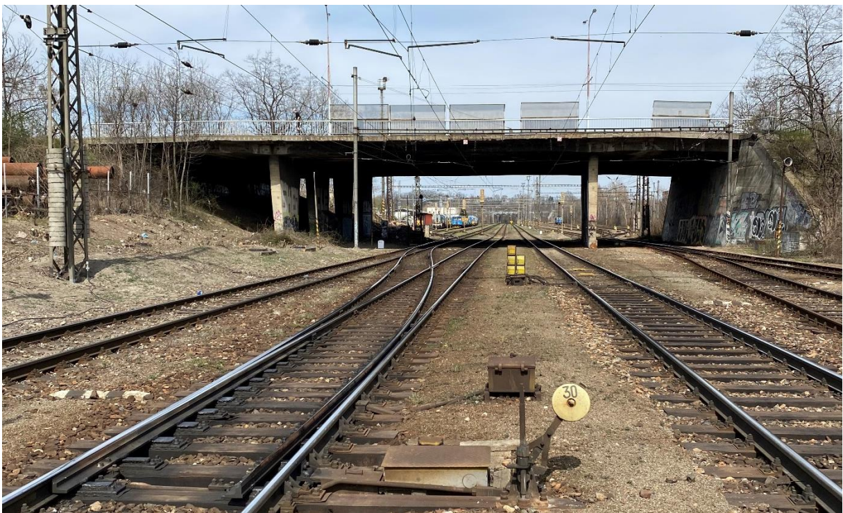
Obrázek 11: Pohled na hlavní koleje s patrnými lomy nivelety, směr Praha-Libeň
