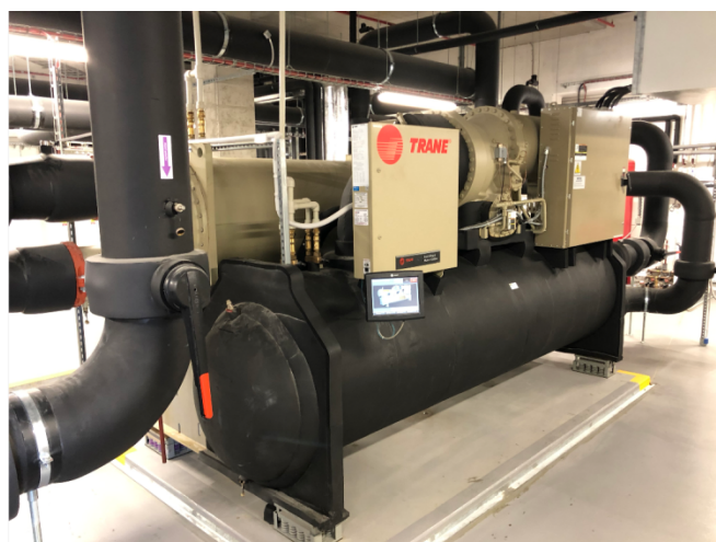
Obr. 5.10 – Turbokompresorová chladicí jednotka TRANE - CVGF
