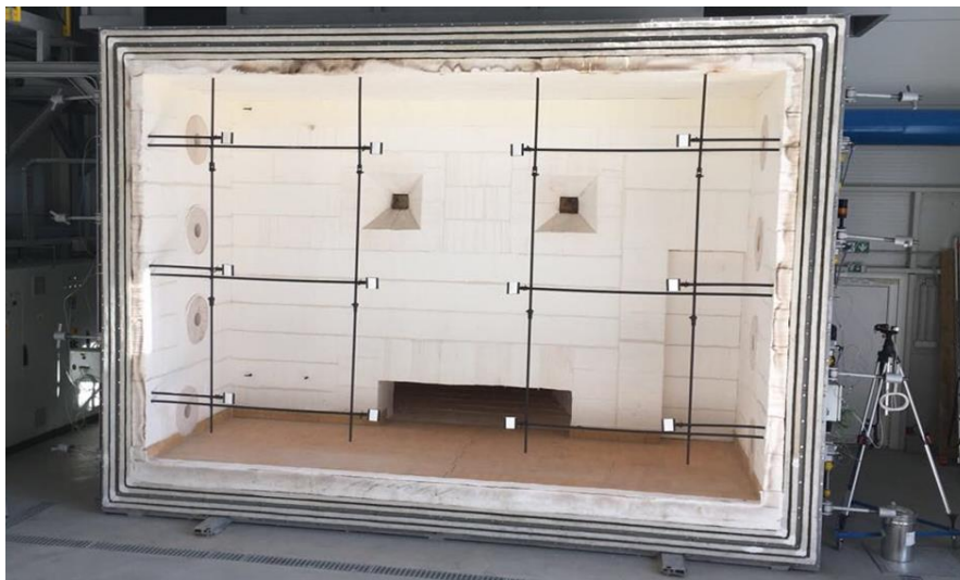
Obr. 17: Odkrytá pec firmy AVAPS s.r.o. [4]
