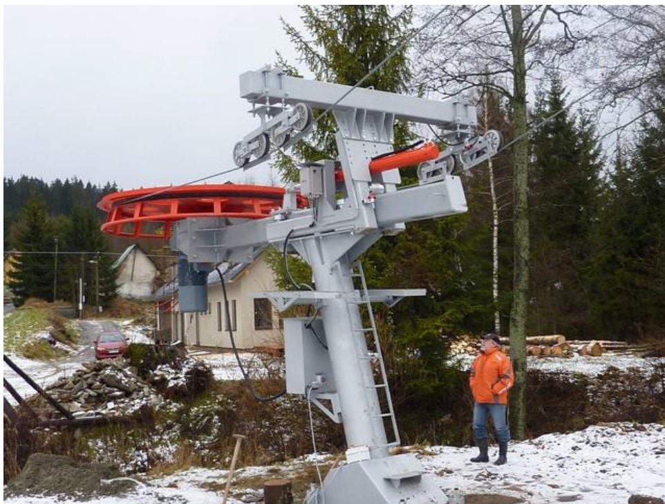
Obrázek 3.6: Poháněcí stanice zařízení s nízkým vedením lana [10]
