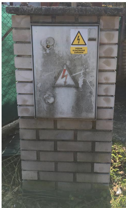
Obr. 2-3: Celokovová přípojková skříň ve zděném pilíři
