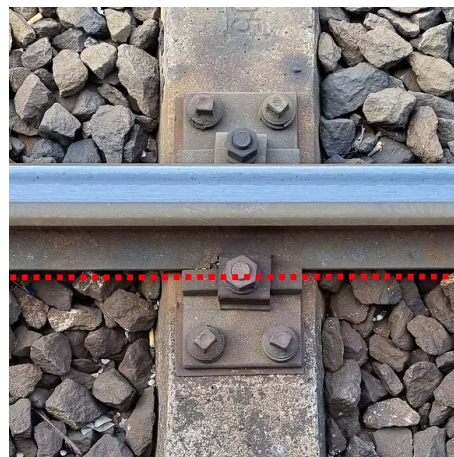
Obrázek 6.3. Použité upevnění kolejnice k pražci typu K s tuhou svěrku ŽS 4 ve stanici Tábor. Červenou tečkovanou čarou je označeno místo snímané senzory.
