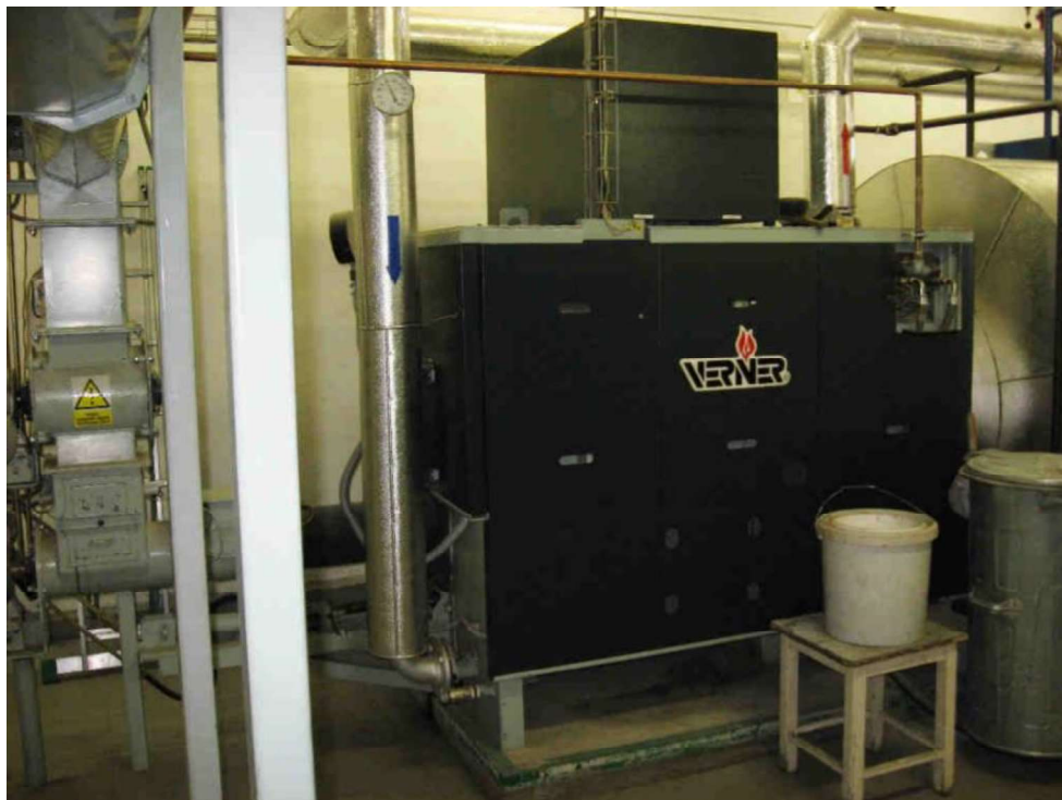
Obrázek 30: Kotel – Výtopna Valašská Bystřice, 0,6+0,9 MWt [60]
