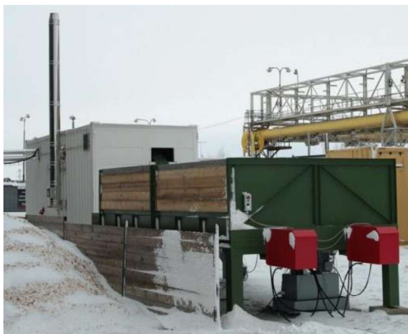
Obrázek 13: Kontejner s jednotkou Wave 120 a zásobník paliva vytápějící hlavní budovu UCEEB [26]
