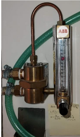
Obr. 28 Průtokoměr s regulačním ventilem
