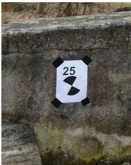
Obr. 18. Štítek s terčovým bodem
