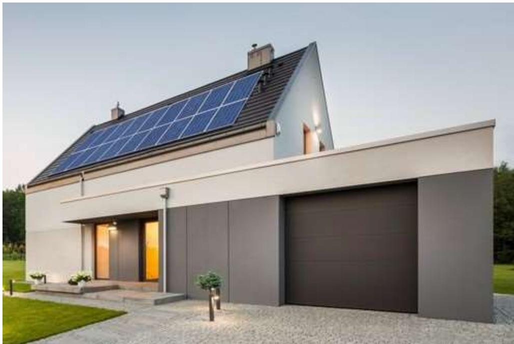
Obrázek 8 - FV panely na RD se šikmou střechou (S-Power Energies, s.r.o., 2018)
