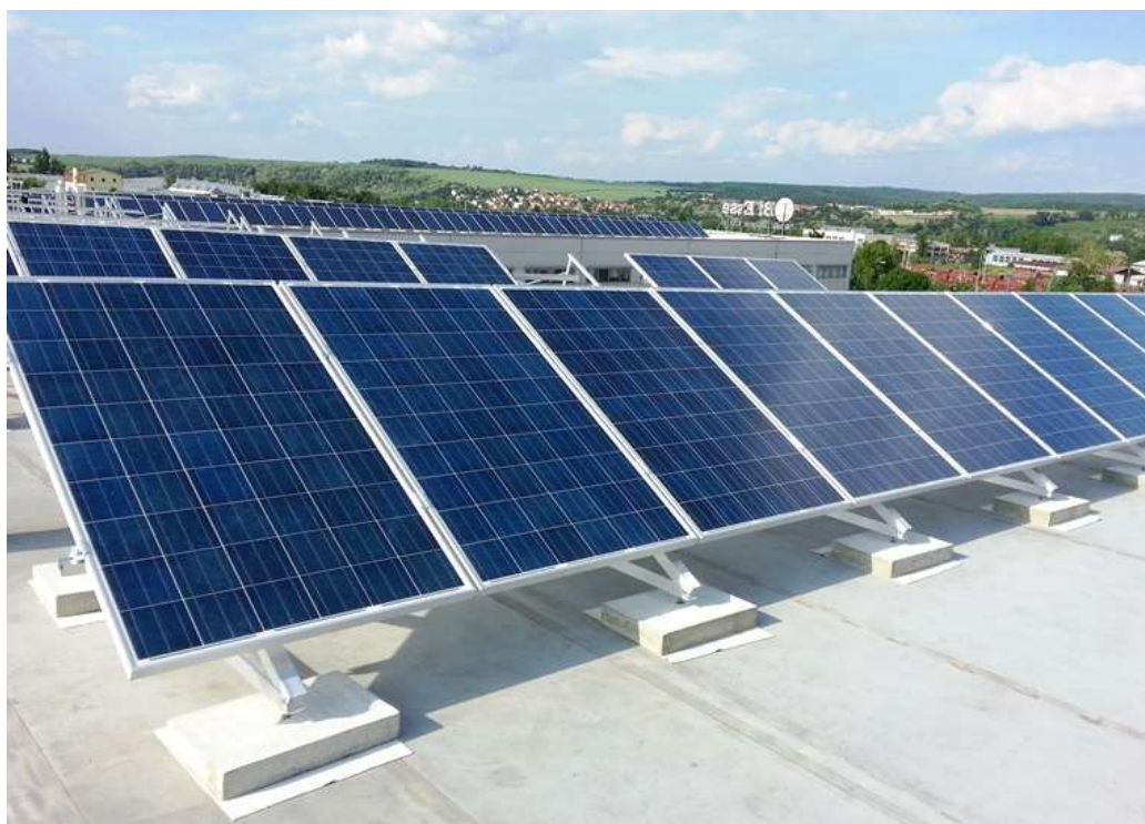
Obrázek 9 - FV panely na rovné střeše (SunWawe, 2013)
