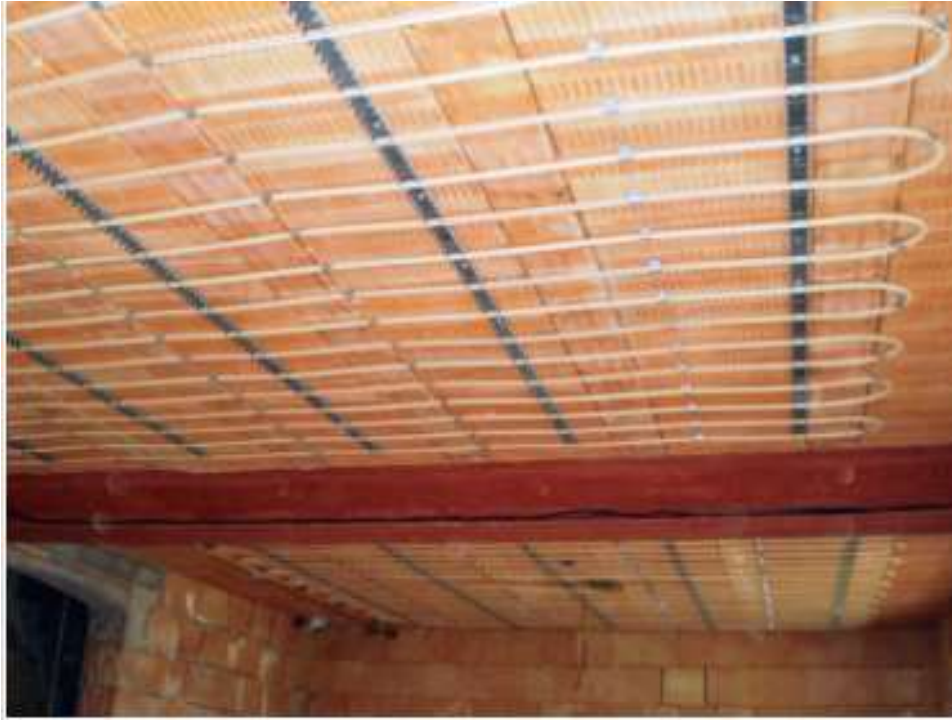
Obrázek 19: Stropní chlazení (ALPHATEC comfort systems s.r.o., 2015)
