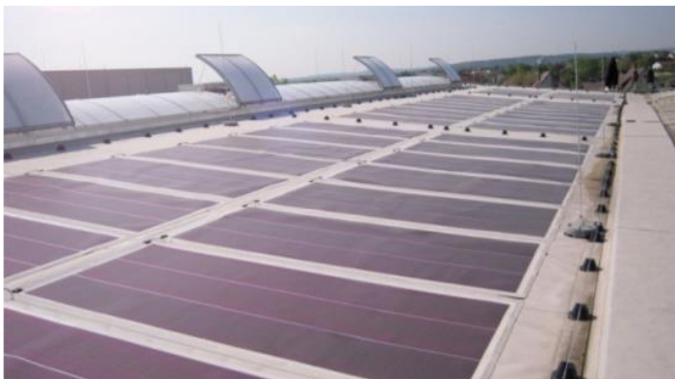
Obrázek 22 Příklad použití tenkovrstvé FV na téměř ploché střeše [34]
