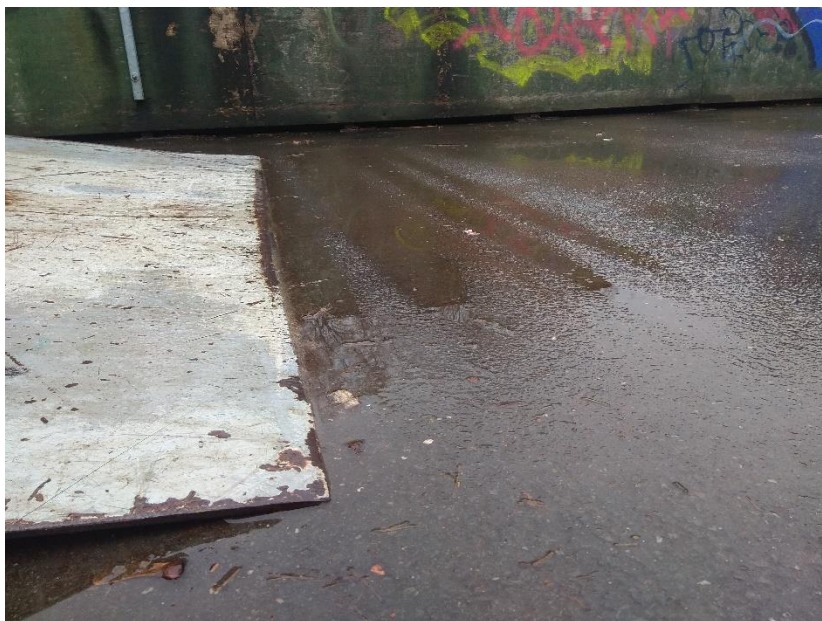
Obr. 5 Skatepark Smíchov, Praha; zvlněný asfalt před nájezdem na překážku
