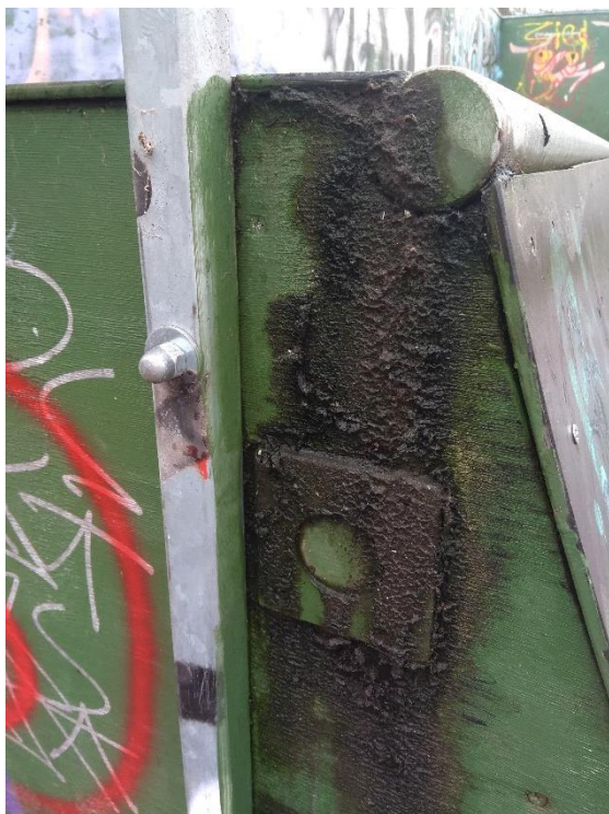
Obr. 4 Skatepark Smíchov, Praha; tlející dřevěné obložení
