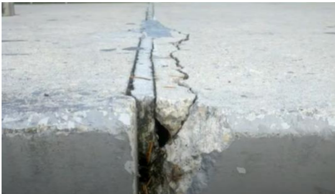
Obr. 13 Ušťipnutá hrana v místě kontaktu dvou prefabrikovaných desek 15
