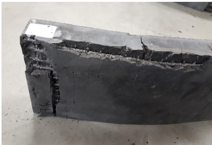
Obrázek 5.23: Ztráta kotvení porušeného prvku MF 482
