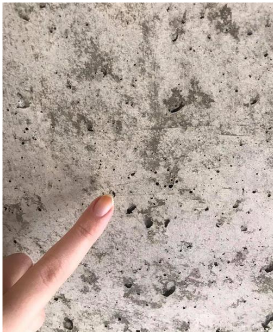
Obrázek 36 - Štěrková hnízda nenarušující funkci konstrukce – archiv autora
