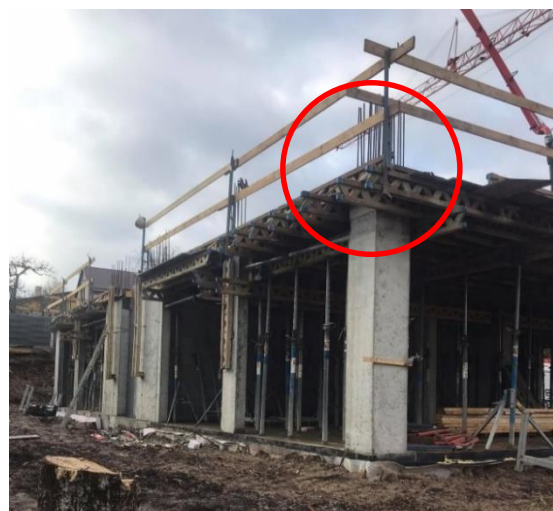
Obrázek 20 – Vyčnívající kotevní pruty výztuže rohového L sloupu nad 1.NP – archiv autora
