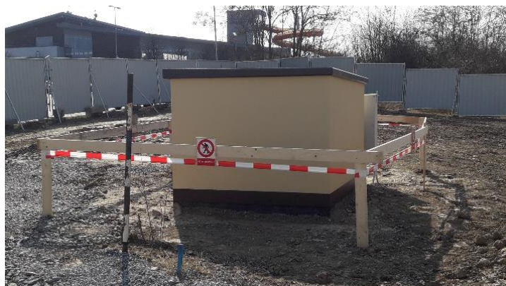
Obr. č. 25 Výstražné vyznačení pro zamezení vstupu
