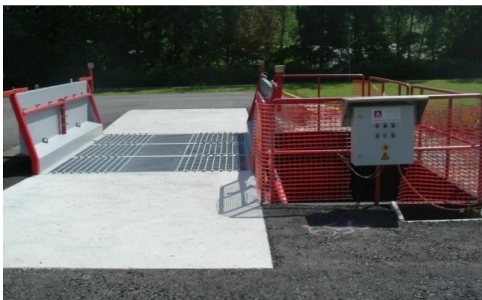
Obr. č. 11 Mycí rampa (10)
