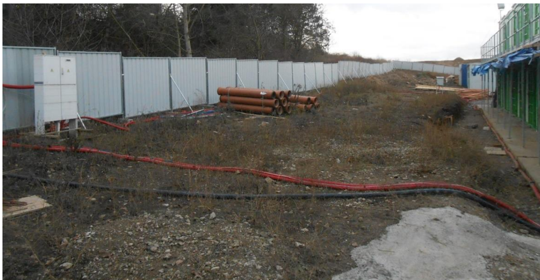
Obr. č. 31 Staveništní rozvaděč a vedení kabelů NN k buňkovišti
