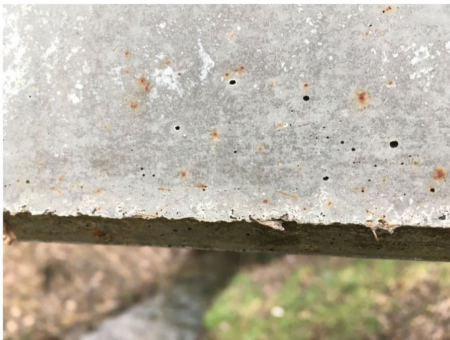
Obrázek 6: Koroze drátkové výztuže v místě zkosení LMR
