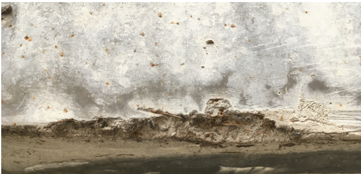
Obrázek 10: Odpadávající hrana betonu - koroze
