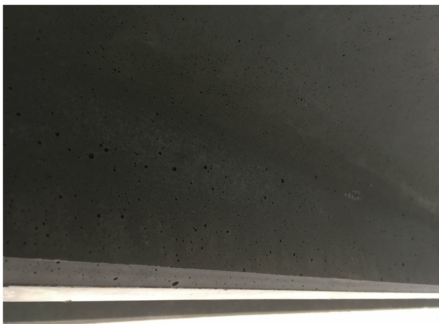
Obrázek 7: Póry na nosné konstrukci LMR
