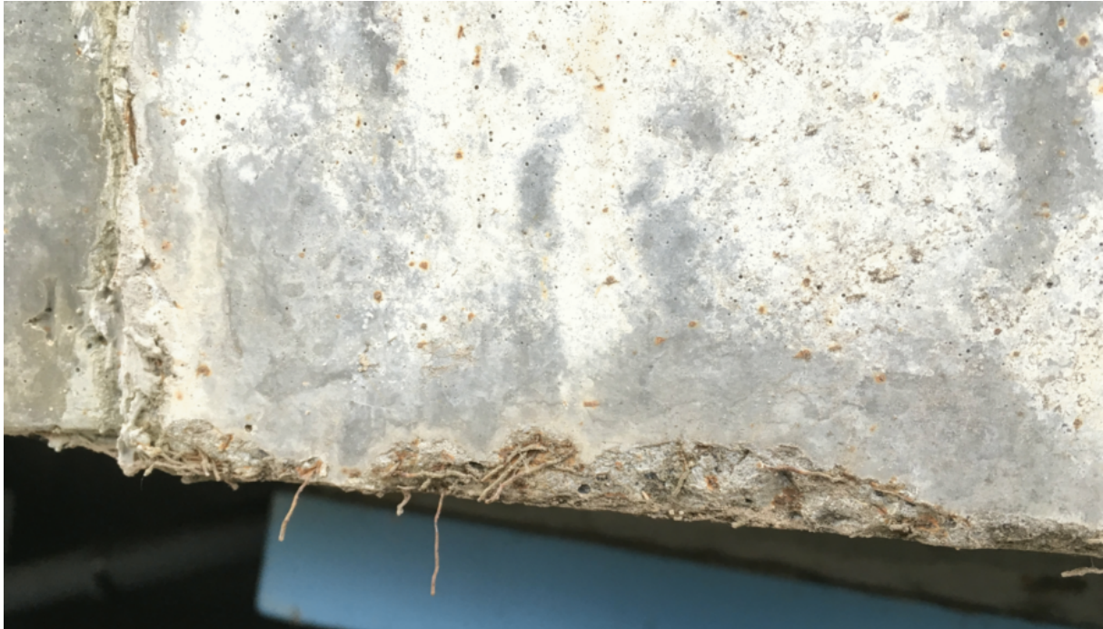
Obrázek 11: Odpadávající hrana betonu - koncentrovaná výztuž
