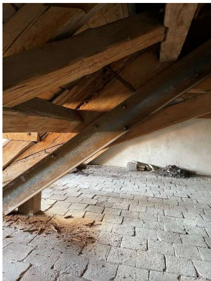
Obr. 34: Foto 8 – oprava + další porucha
