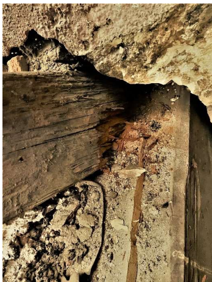
Obr. 124: Poškozený dřevěný prvek + zdivo
