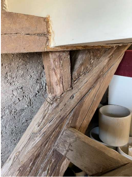
Obr. 30. Foto 3 – patrné poškození zatékáním
