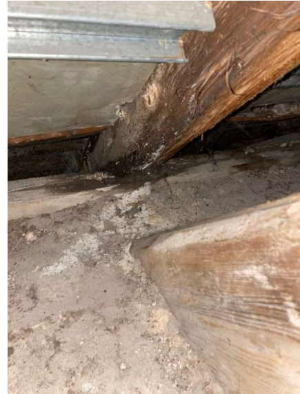
Obr. 31: Foto 2 -zatékání (srážení) vody v oblasti námětku
