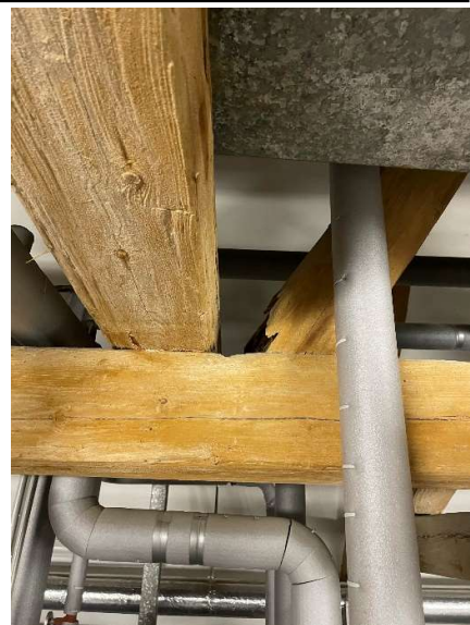
Obr. 37 Foto 13 – trámovka v kotelně
