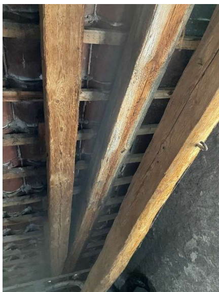
Obr. 42: Foto 14 - degradace krokve
