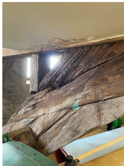
Obr. 33: Foto 6 – zanechaná porucha
