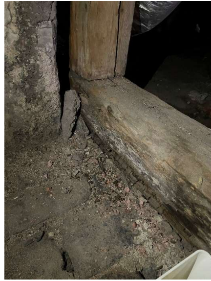
Obr. 45: Foto 19 – degradace vazného trámu
